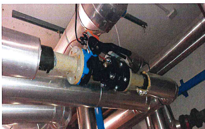
Foto 5. Misuratori di controllo (impianti termici ed elettrici)
